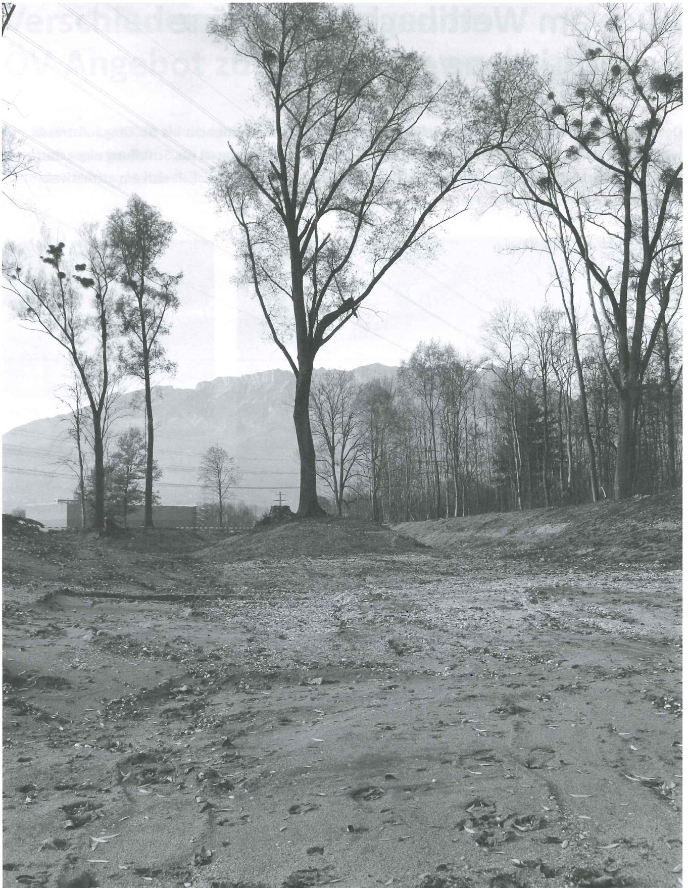
Hier wird bald Wasser fließen: Die Bauunternehmen gestalten die bis zu 60 Meter breite Flusssohle.
